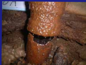
破損した排水本管
